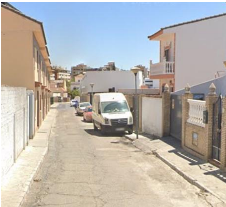
Imagen 6. Camino de Gelves. Pavimentos y calzada en mal estado.
