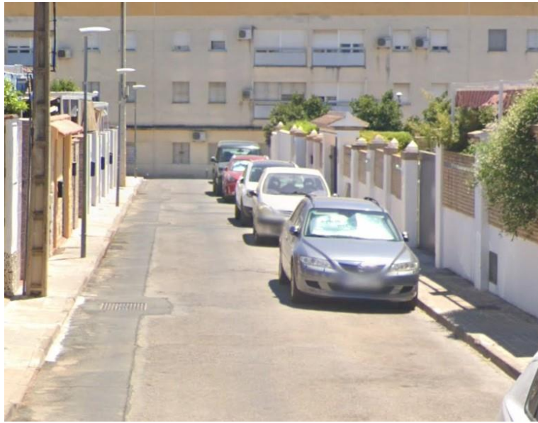
Imagen 15. C/ Olivar de la Cruz. Calzada en mal estado. Banda de aparcamiento lateral.
