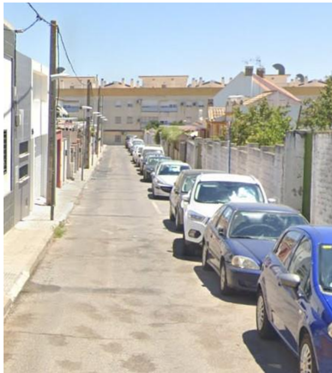
Imagen 14. C/ Olivar de la Cruz. Calzada en mal estado. Banda de aparcamiento lateral.
