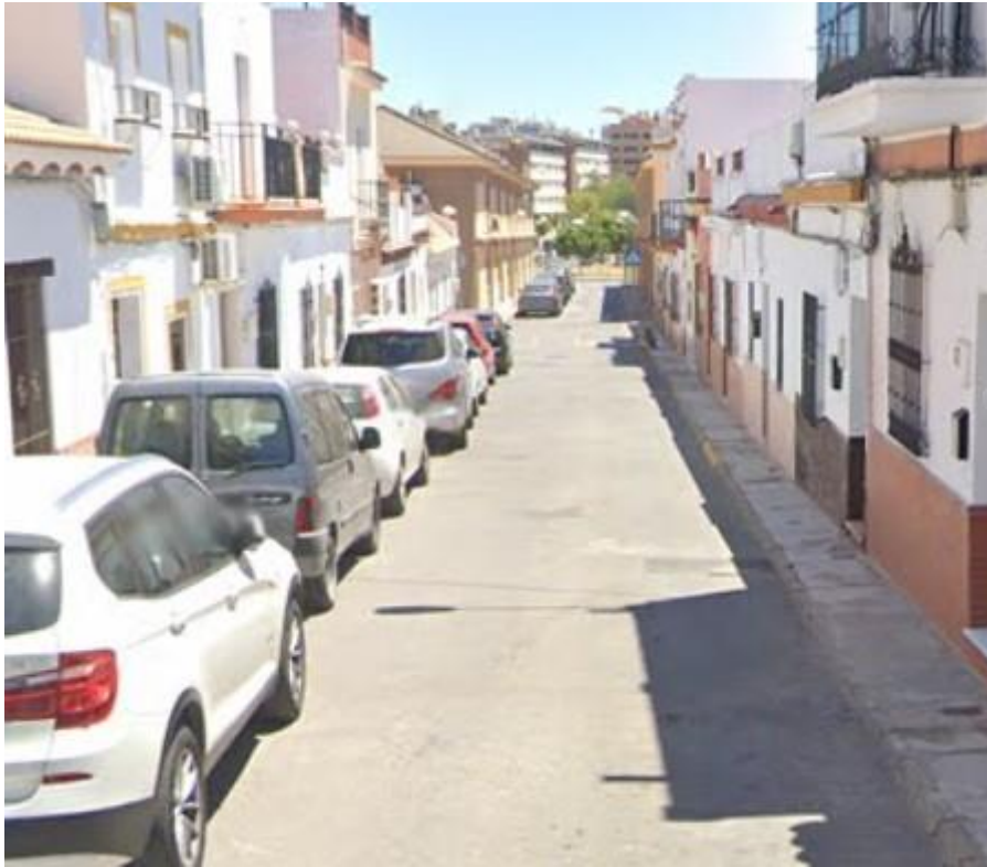
Imagen 9. C/ Dolores Solano. Calzada y aceras en mal estado. Línea de vehículos estacionados en un lateral.
