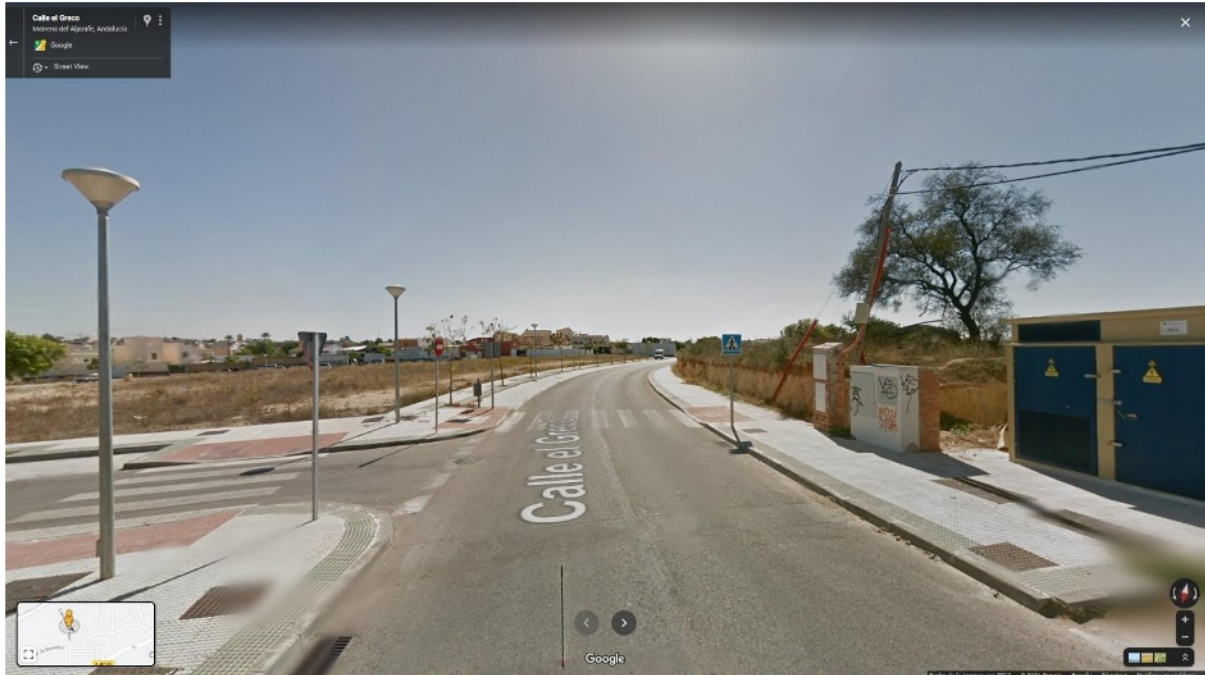
Foto 5. Camino de Peralta (Calle El Greco) con vuelta a Calle Ceuta (Esquina NW). CENTRO DE TRANSFORMACIÓN CT2
